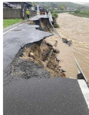
(瑞浪市：崩落した路肩)
