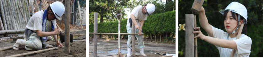
「四ツ目垣」という垣根を作っています。水系を張り竹の高さを揃えています。
