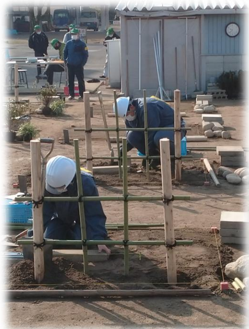
竹垣を作成し終わり縁石等の設置に取り掛かっています
