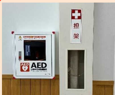
北舎2階 北側中央 憩いのスペース (↑隣に担架もあります。)
