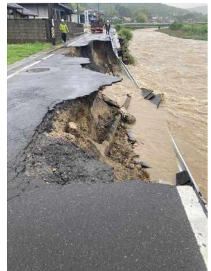
(瑞浪市：崩落した路肩)
